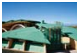
Chiesa di pellegrinaggio «Padre Pio», San Giovanni Rotondo (FG) Renzo Piano Building Workshop, Genova WAL S.r.l., Bregnano (CO) TECU® Patina
